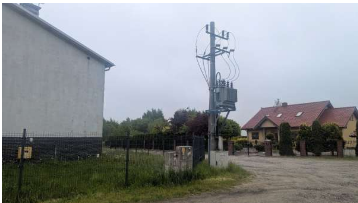
Fotografia 3. Transformator linii średniego napięcia przebiegająca przez analizowany teren. Zdjęcia własne wykonane w trakcie wizji terenowej.
